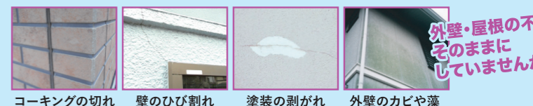
コーキングの切れ 壁のひび割れ 塗装の剥がれ 外壁のカビや藻
